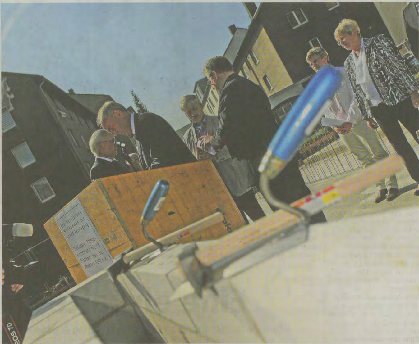
Der Bau hat bereits begonnen: Bevor es weitergehen kann, muss noch die Zeitkapsel eingemauert werden.
